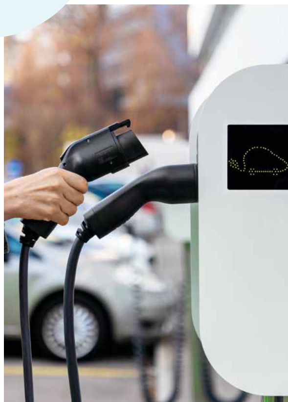
En 2021, trois bornes de recharge pour voitures hybrides et électriques ont été installées sur les places de parc de la Loterie Romande.
